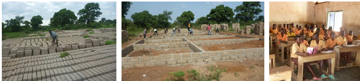
Anfertigung der Steine, Legen des Fundaments für die JHS, der erste Jahrgang der JHS (links nach rechts)
